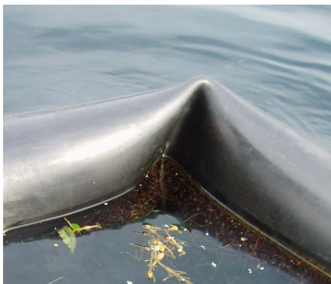
Figur 7 Lokal knekking av plastrør.
